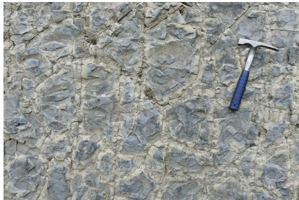
Bild 2: Entfärbung der Mergelsteine entlang von Kluftrissen
