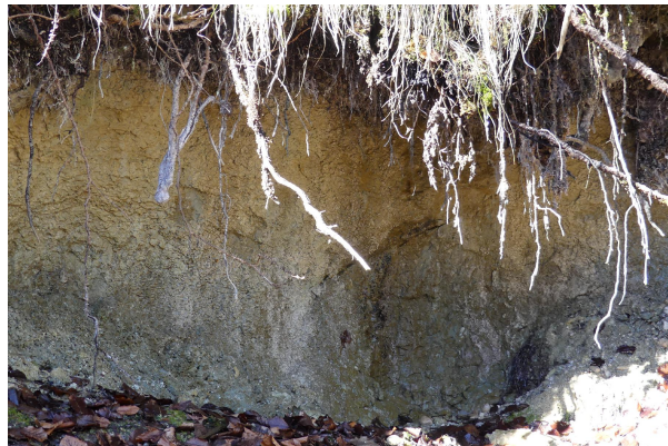
Bild 2: Wasseraustritt aus postglazialen Flussschottern auf Mergeln der Molasse
