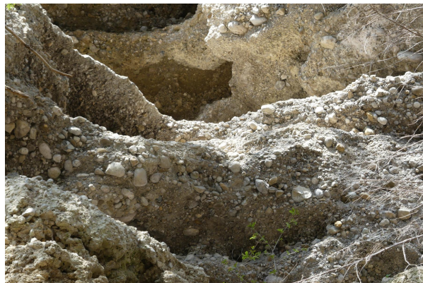
Bild 4: Ausgewitterte und unterhöhlte Nagelfluh
