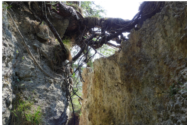
Bild 2: Gepantante Wurzeln über Trennfuge
