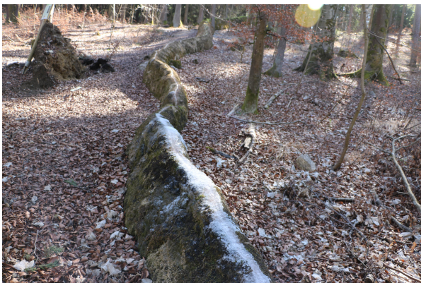
Bild 3: Im unteren Bereich ist die Rinne zum Teil bereits trockengefallen, da es im Oberlauf zu viele Wasseraustritte gibt.
