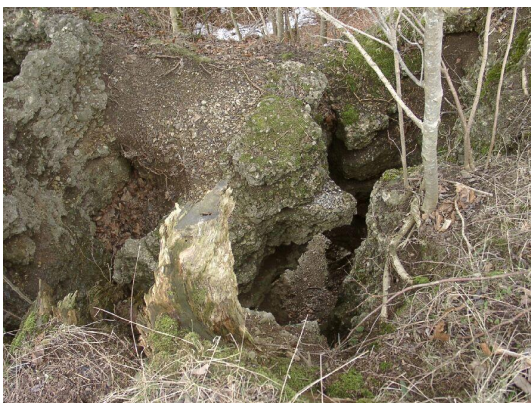
Bild 3: Hohlräume im verfestigten Schottermaterial. Absturzgefahr!
