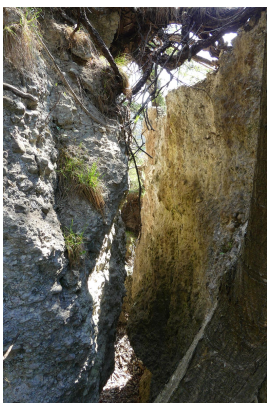
Bild 3: Trennfuge in Nagelfluh
