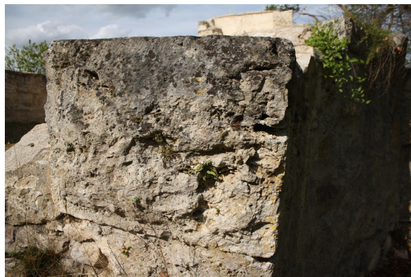
Bild 4: Schwammdolomit der Unteren Frankenalb-Formation ("Malm Delta") im Mauerwerk der Kirchenruine Hl. Kreuz
